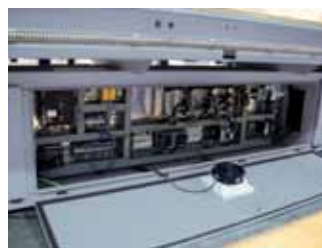
Armadio elettrico integrato nel basamento Electrical cabinet integrated into the basement
